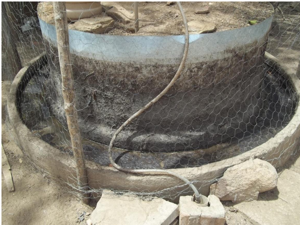
Figura 33: Mangueira utilizada para levar o biogás para dentro da residência para ser utilizado como gás de cozinha
